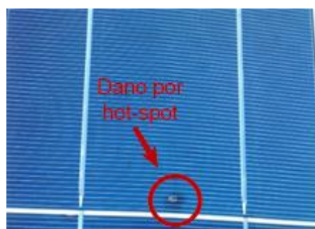
Figura 5- Célula solar danificada pelo efeito “hot spot”
